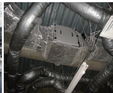
事務所の外気取入れ (厨房の臭い対策)
